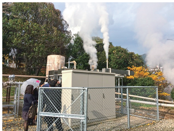
湯けむり発電施設 実用2号機 外観
